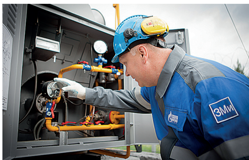
Настройка работы подогревателя газа
