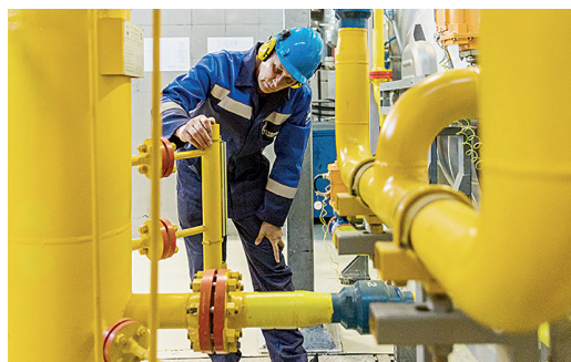
Обход работающего оборудования ГПА-32 «Ладога»
