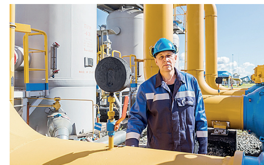
На узле очистки газа компрессорного цеха
