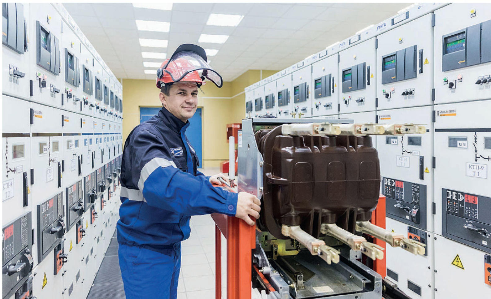
Техническое обслуживание высоковольтного элегазового выключателя
