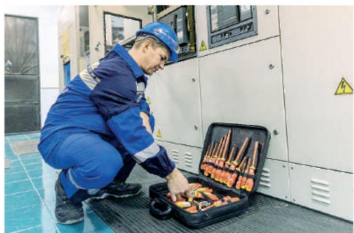
Технический осмотр ячеек ЗРУ 10 кВ
